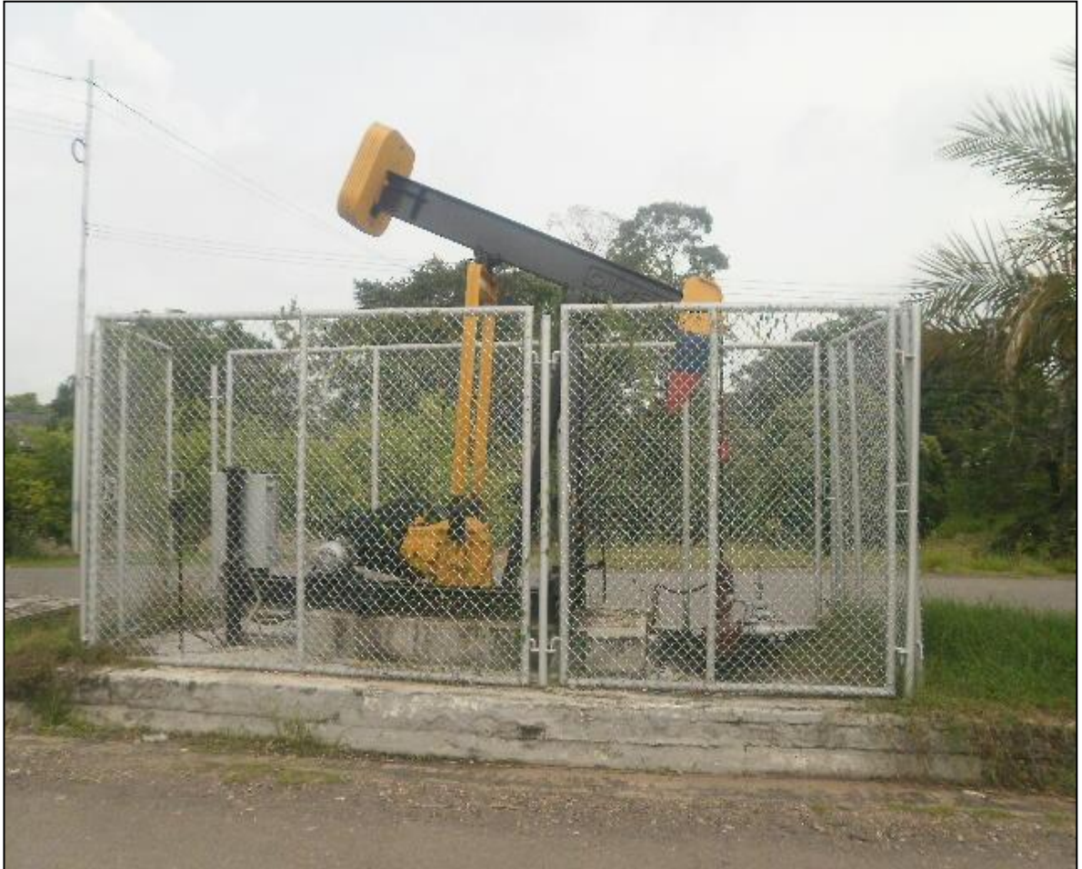
Figura 17. Unidad de bombeo mecánico Churchill campo la Cira Infantas
