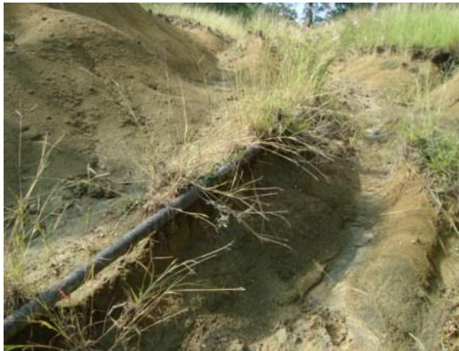
Figura 14. Cárcava en derecho de vía genera por la escorrentía
