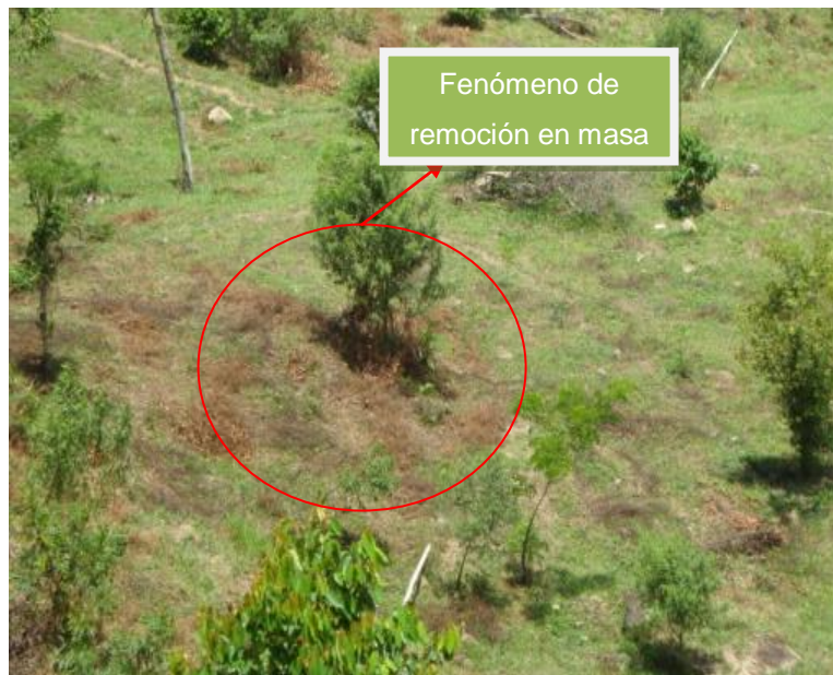
Figura 9. Deslizamiento en masa en el derecho de vía. §
