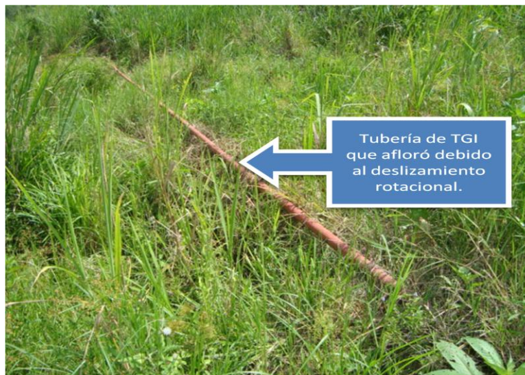
Figura 10. Afloramiento de la tubería debido a un deslizamiento rotacional
