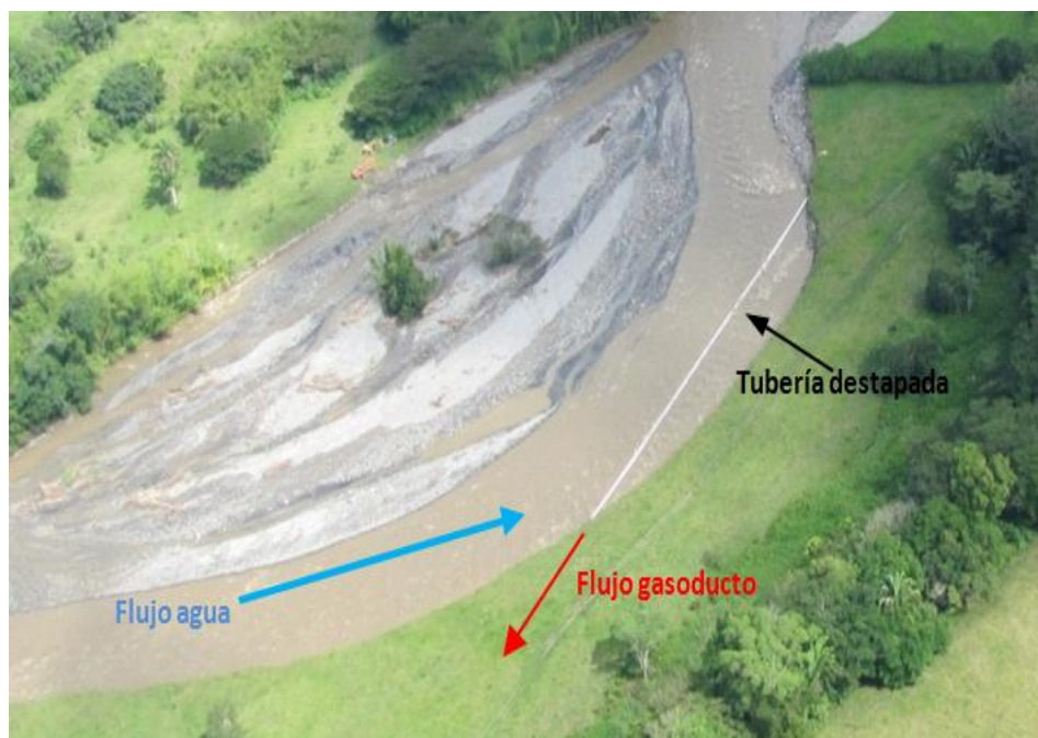
Figura 15. Tubería destapada por la erosión fluvial ††
