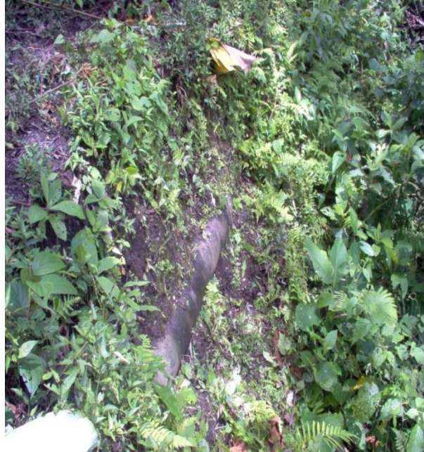
Figura 12. Tubería afectada por un movimiento de reptación**
