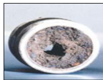
(b) Deposito asfaltenico
