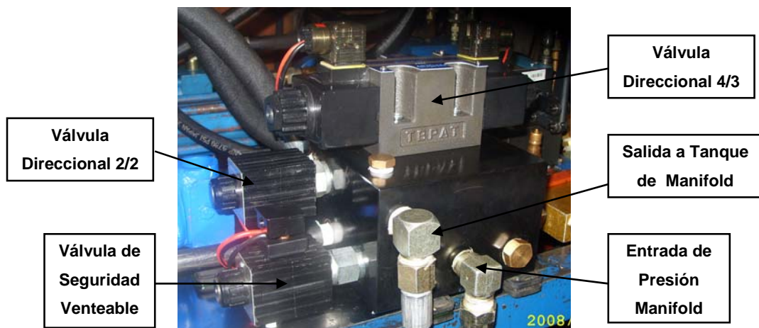
Figura 3.36. Disposición final válvulas de sistema hidráulico modular.
