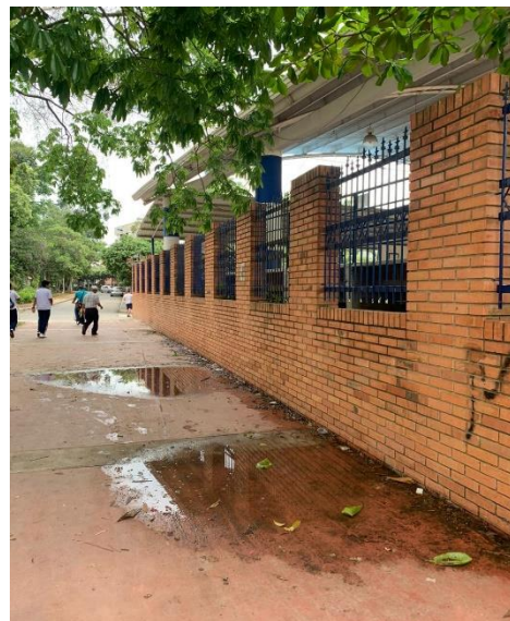
Imagen 2. Estancamiento de agua lluvia en pista atlética
