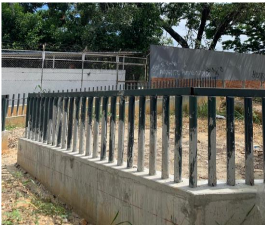
Imagen 1. Cerramiento de tubo circular para juego infantil en estado de suciedad.
