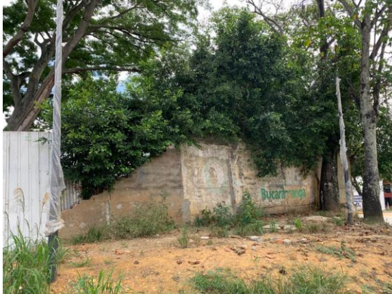
Imagen 3. Muro que colinda con el parque recrear inclinado.
