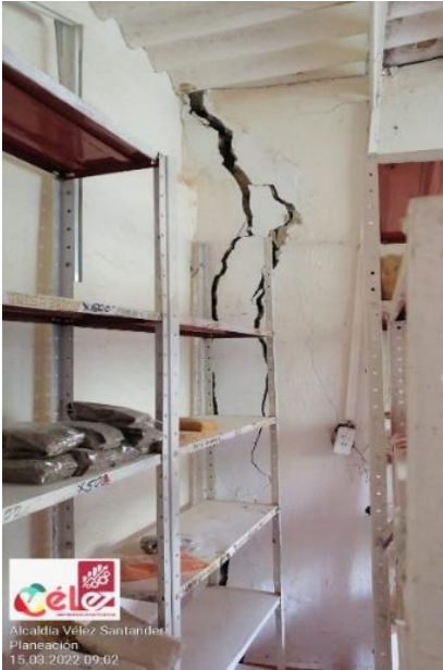
Figura 1. Agrietamientos en muros de la vivienda.
