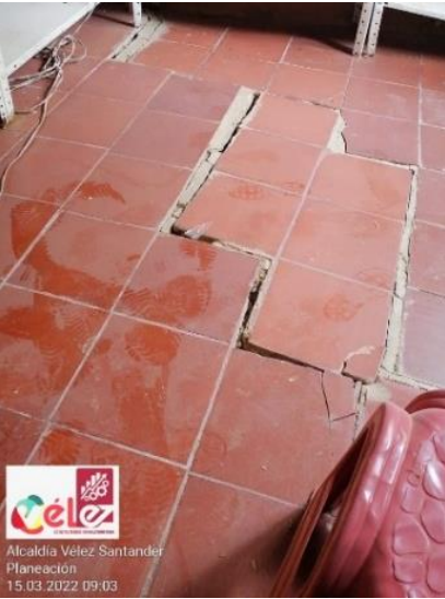
Figura 2. Agrietamientos en el piso de la vivienda.
