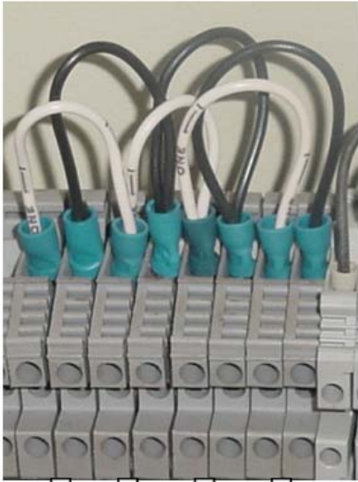
Figura 77. Borneras de conexión de los sistemas
