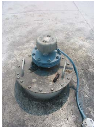
Medidor en el tanque
