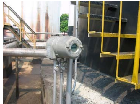
Unidad de Control para cada tanque
