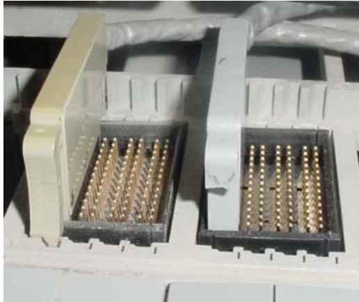
Figura 73. Conexión del cable 7 con el bus del integrador
