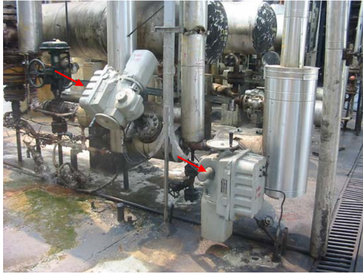
Figura 7. Fotografía de las Válvulas MOVs en campo
