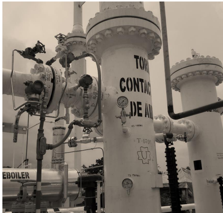
Figura 5. Base de la torre contactora de amina
