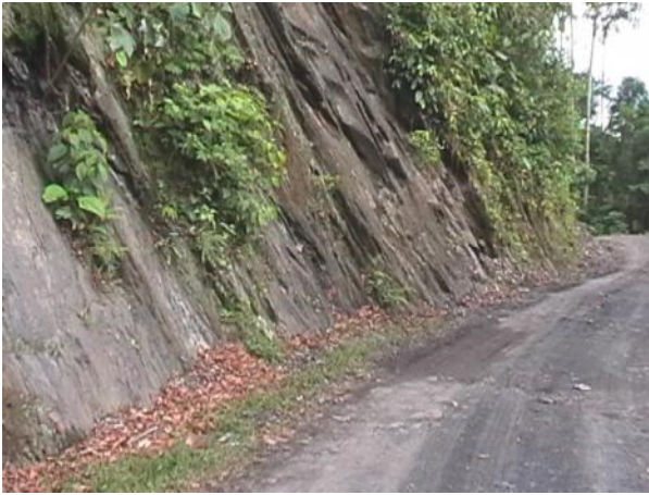
Figura 31. Deslizamiento planar ocasionado por la ampliación de la vía Cimitarra – Landázuri. Santander.
