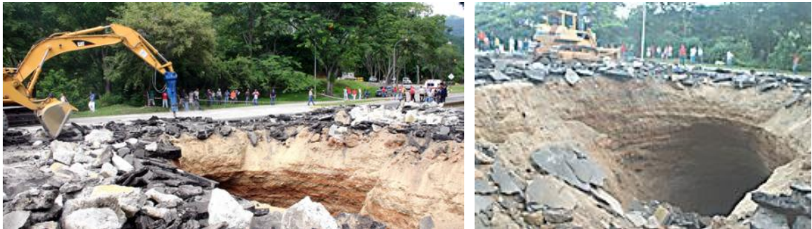
Figura 35. Destrucción de un tramo de la autopista Maracay – Caracas en Venezuela debido a la acción del agua subterránea.
