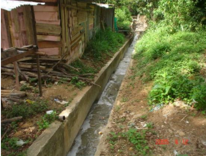
Figura 27. Colector de aguas lluvias.
