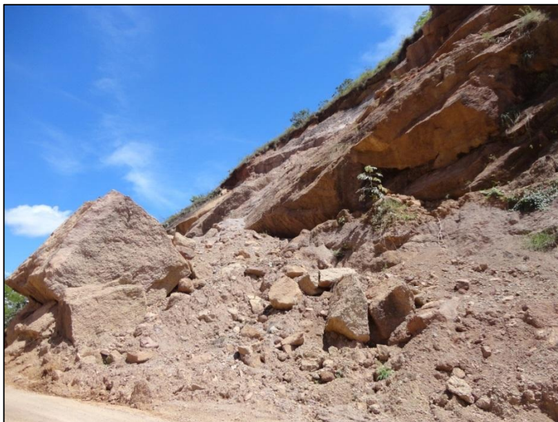
Figura 22. Caída de rocas ubicado en el margen derecho de la carretera que comunica el municipio de Palermo con el Corregimiento de San Luis.
