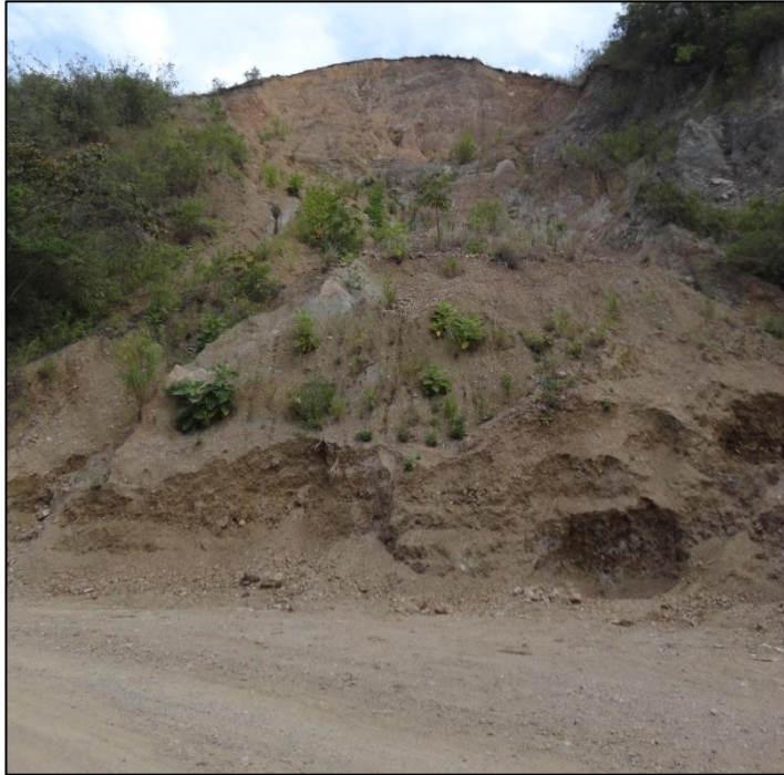
Figura 24. Deslizamiento traslacional ubicado sobre la vía secundaria Gigante – Hobo.
