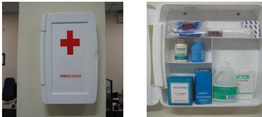
Foto 16. Inspección botiquín Alumbrado Público Bucaramanga.
