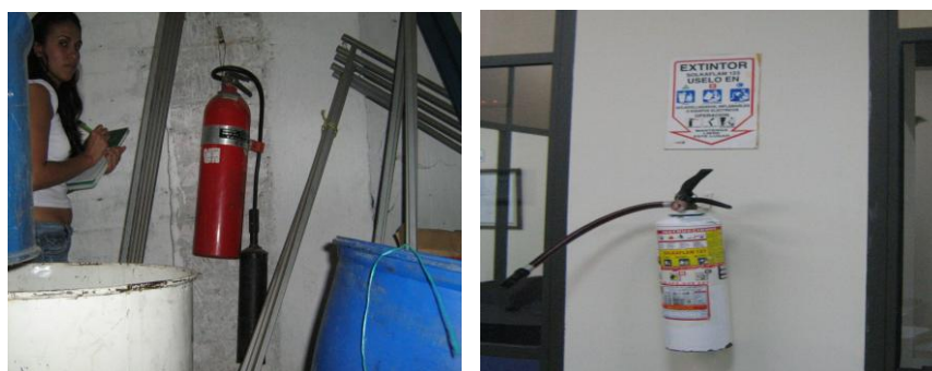
Foto 17. Inspección a extintores
