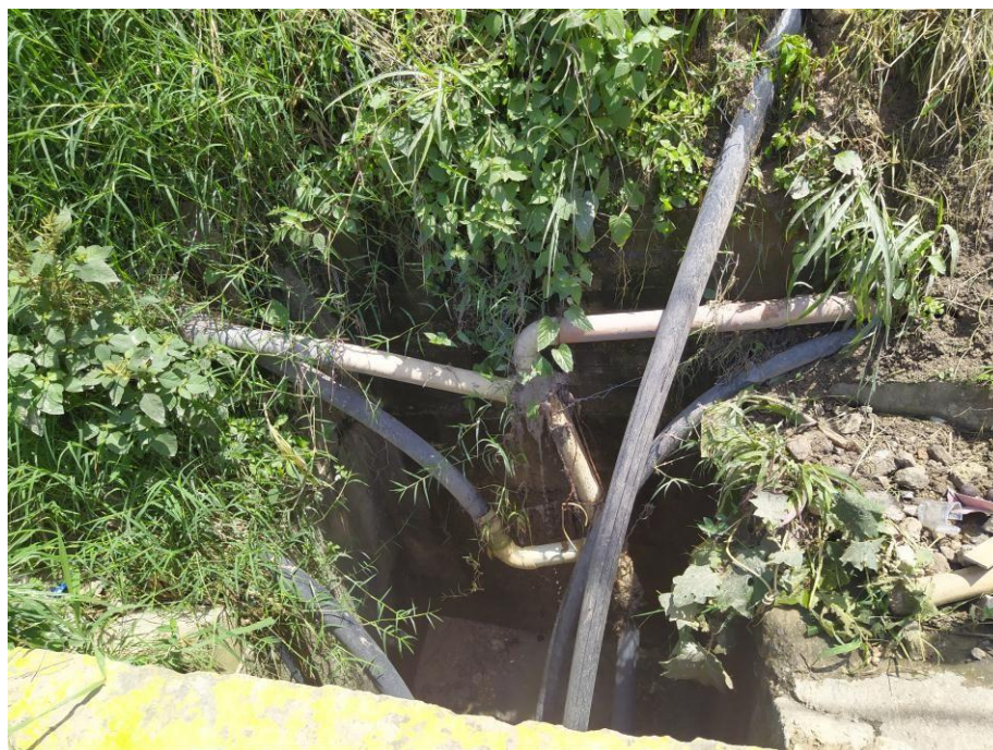
Ilustración 7: Vertimientos que se realizan al Box Colvert.
