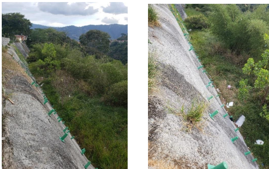
IMAGEN 4: RUÍZ E (2022) Escarpa occidental del municipio de Bucaramanga Santander. Calle 27 entre carrera 7 y 8. Elaboración propia.
