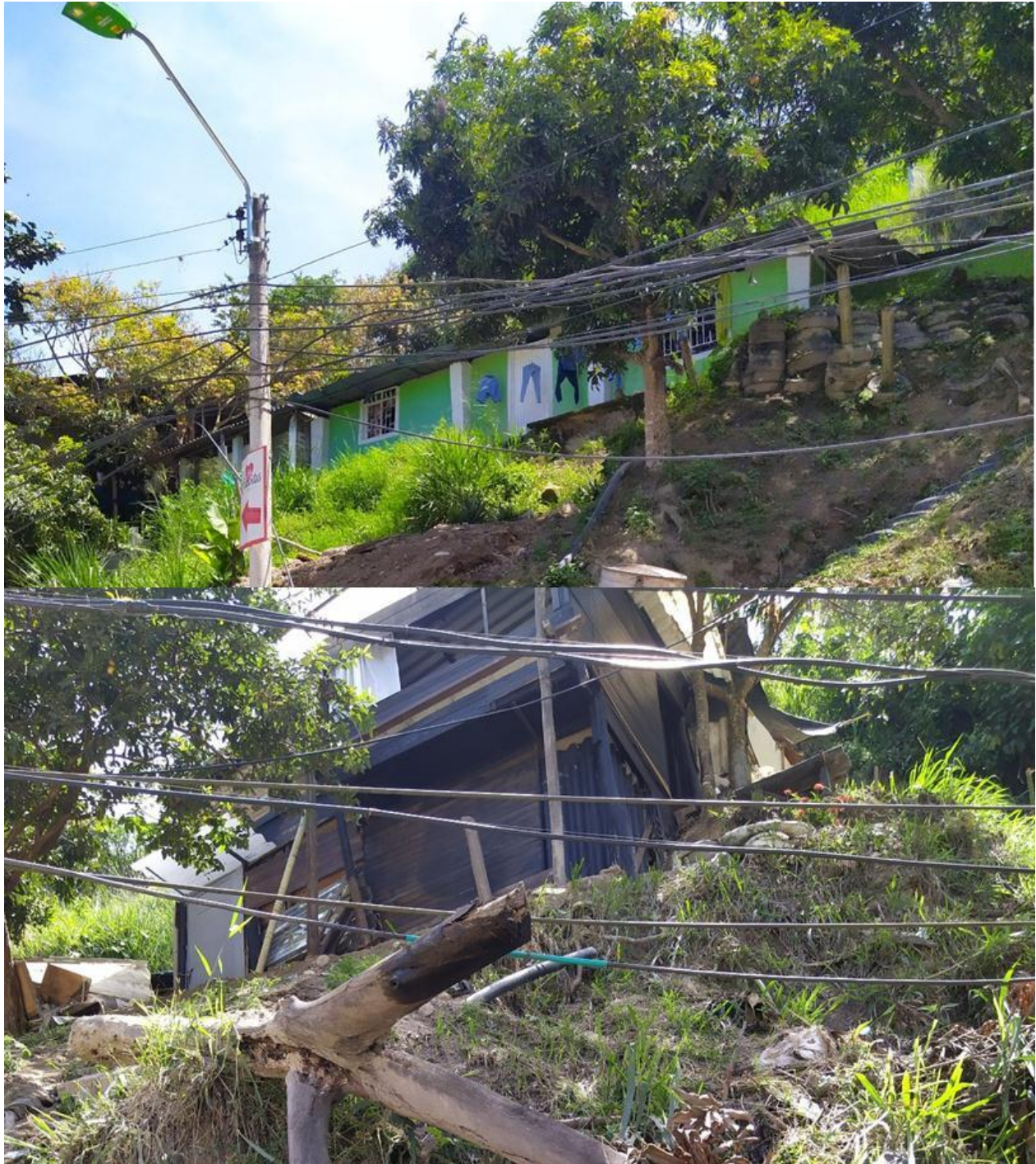
Ilustración 8: tubos que conducen agua sobre la red eléctrica.
