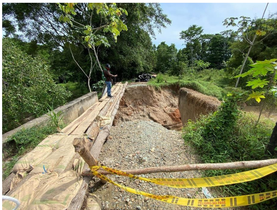
Foto 1 Pérdida de la banca sobre el estribo derecho del Puente Las Avispas – Fuente propia 21-05-2021
