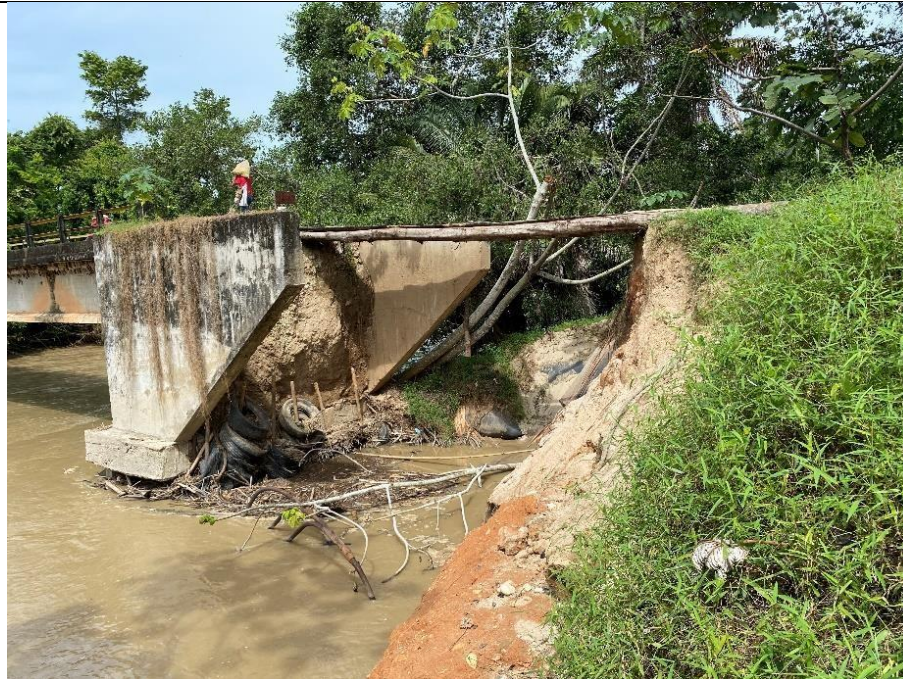
Foto 2 Socavación en la base del estribo derecho del Puente – Fuente propia 21-05-2021
