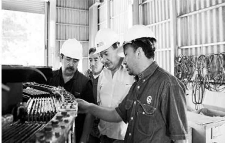
Figura 19. Revisión Sistema Eléctrico y Electrónico. Unidades de Generación.
