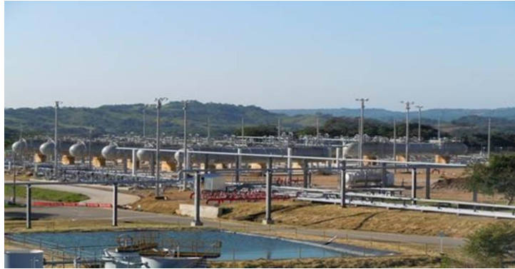
Figura 26 Balas de almacenamiento de GLP CPF Cusiana
