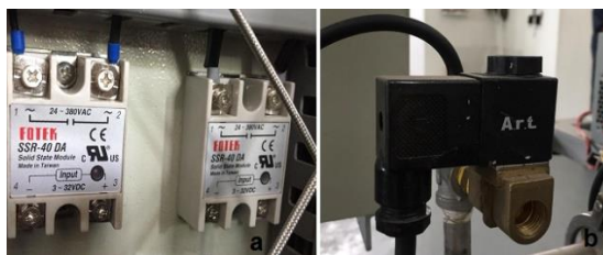
Figura 10. Elementos finales de control. a) Relés de estado sólido. b) Válvula solenoide electrónica.
