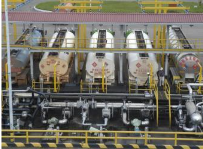
Figura 7. Sistema de descargadero Carrotanques.
