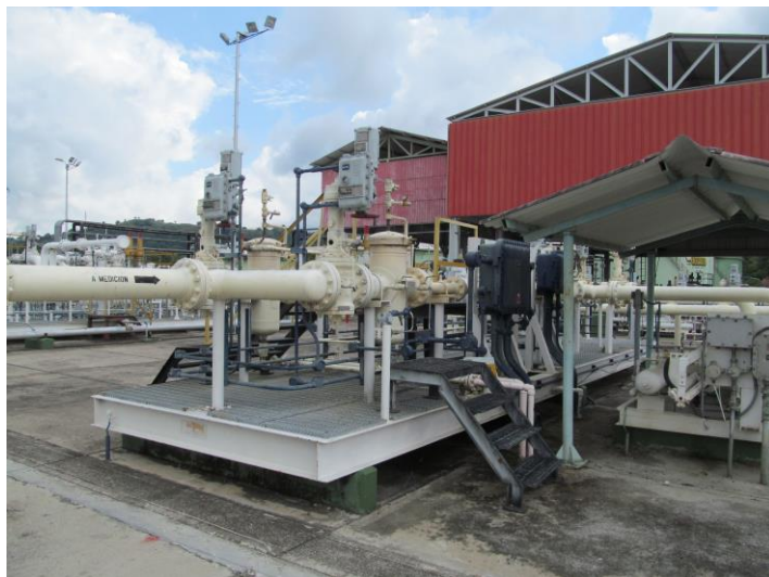
Figura 8. Sistema de medición de Crudo.
