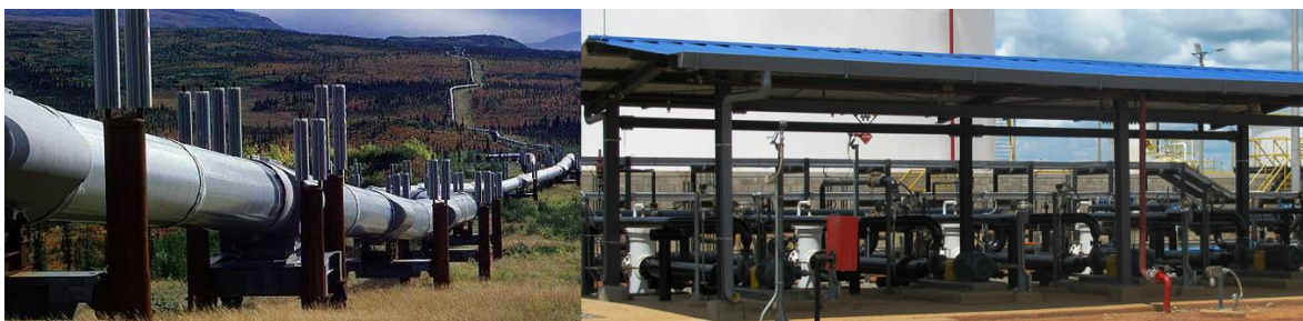
Figura 5. Oleoducto y estación de bombeo de hidrocarburos.
