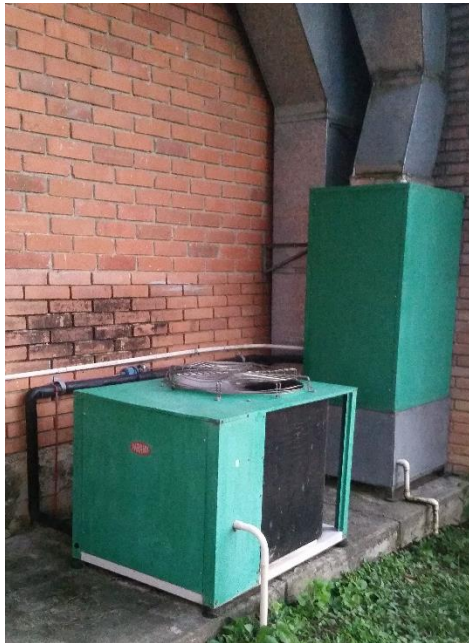
Figura 81. Aire acondicionado exterior edificio DC
