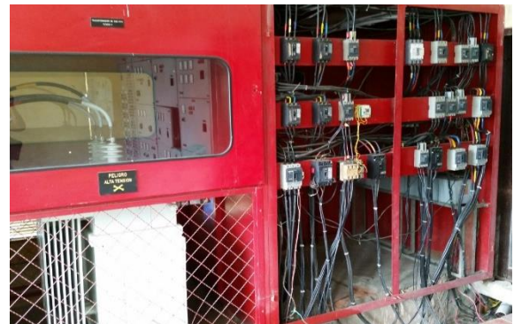
Figura 47. Subestación edificio Alta Tensión
