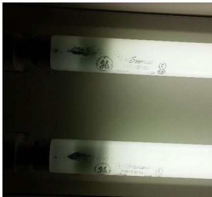
Figura 22. Luminaria tipo T8 Ed.
