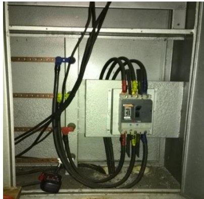
Figura 3. Acometida salón 111 edificio Federico Mamitza Bayer
