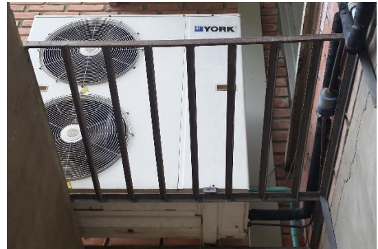
Figura 80. Aula 104 Aire acondicionado Ed. FMB, buen estado de los aislamientos térmicos.
