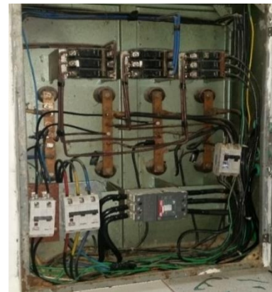
Figura 4. Tablero General 2 salón 105 edificio. Federico Mamitza Bayer
