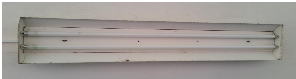
Figura 24. Plafón luminaria tipo tubo edificio FMB
