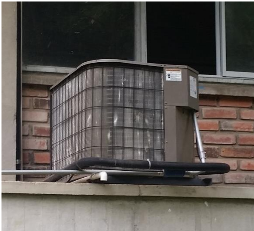
Figura 79. Aire acondicionado Ed. FMB, buen estado de los aislamientos térmicos.
