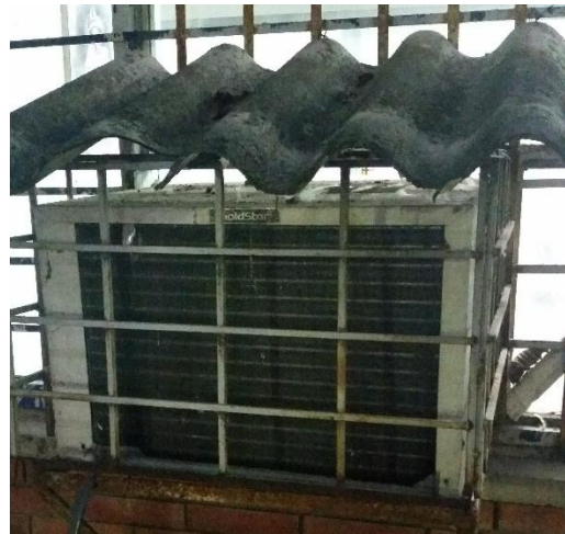
Figura 82. Aire acondicionado tipo ventana edificio DC
