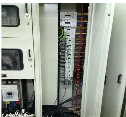
Figura 2. Barraje Subestación Biblioteca
