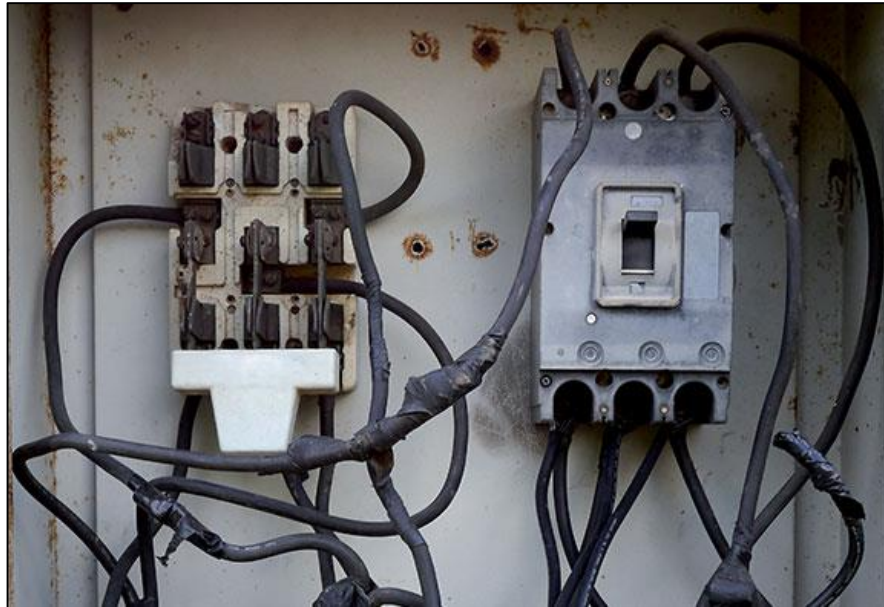
Figura 10. Empalme de cableado de alta tensión con cinta, tablero sin protección y oxidado.
