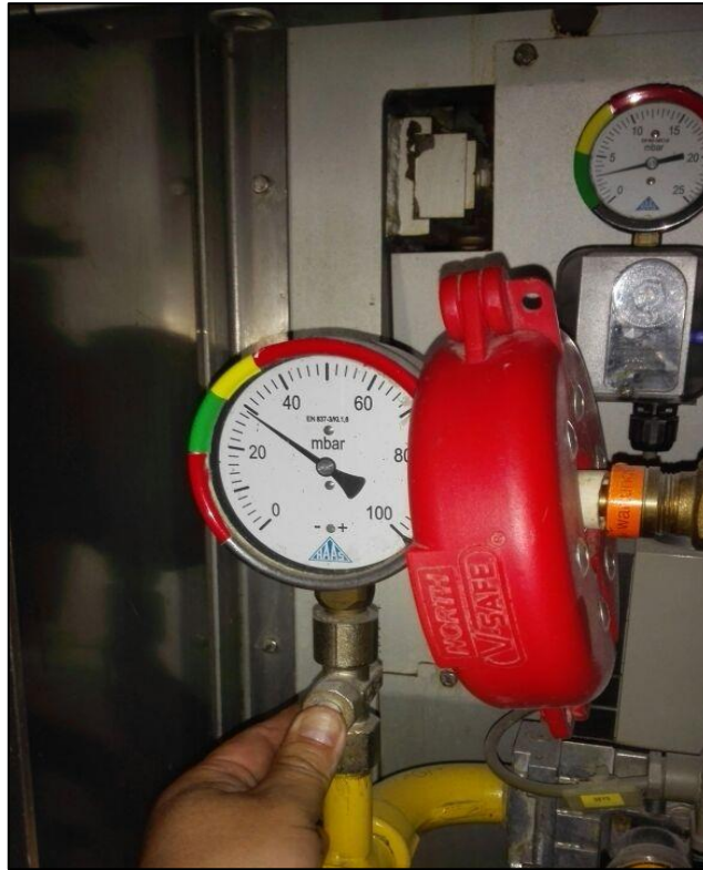
Figura 44. Puntos de control visual en el equipo.
