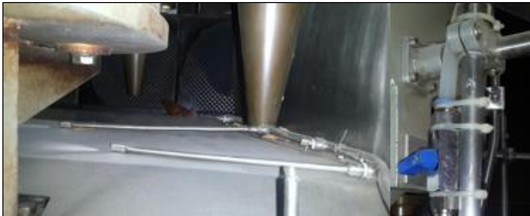
Figura 60. Sistema neumático para retiro de desperdicio.
