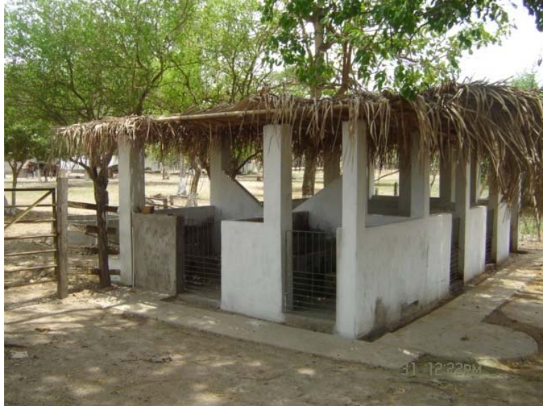
Figura 56. Tanques para pozo séptico al lado derecho de la porqueriza
