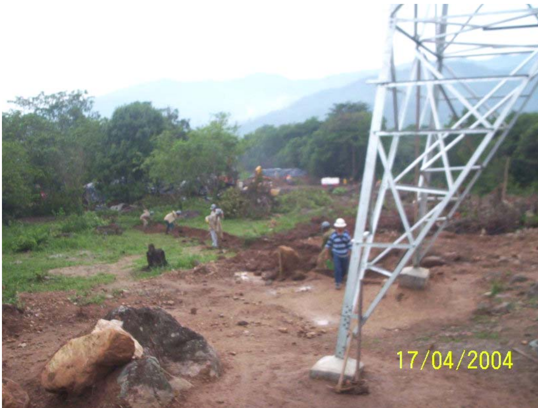
Figura 37. Fotografía de excavación de la zanja para la instalación de los contrapesos. Vista lateral.
