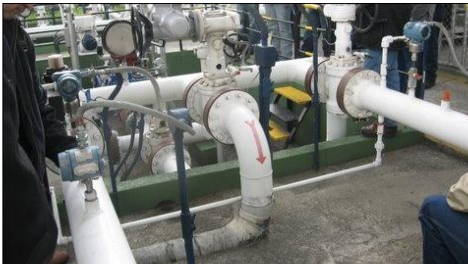
Figura 14. Transmisores de presión y temperatura sistema de medición
