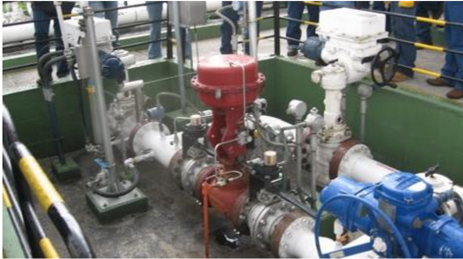
Figura 15. Densitómetro y válvula de contrapresión del sistema de medición
