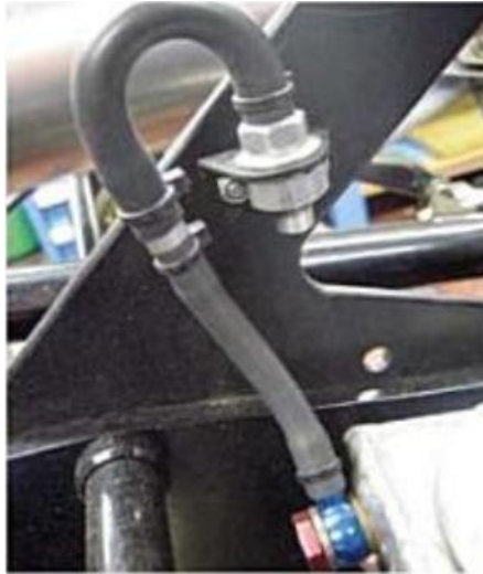
Figura 43. Orificio de venteo del tanque
