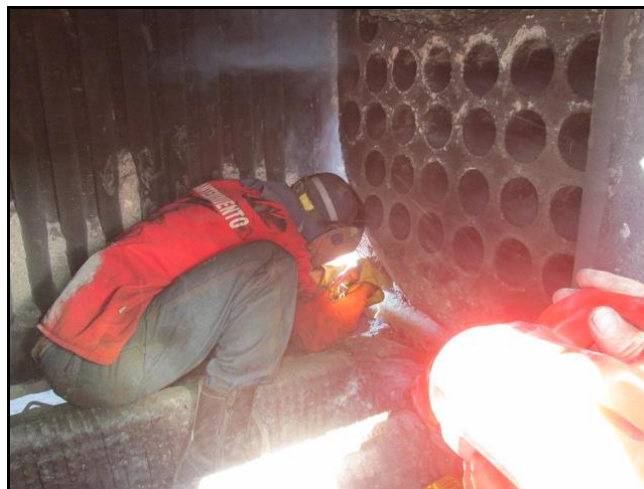
Ilustración 19 Mantenimiento al hogar de la caldera.
