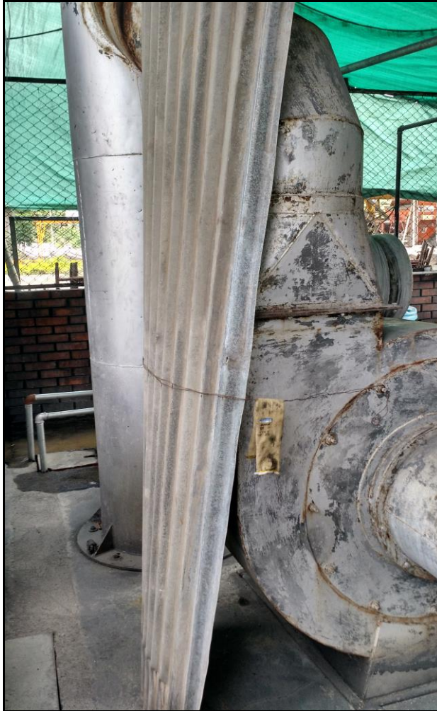
Ilustración 11 Chimenea y ciclón
