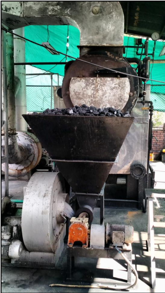
Ilustración 9 Caldera de sistema mixto Pretector Ltda.
