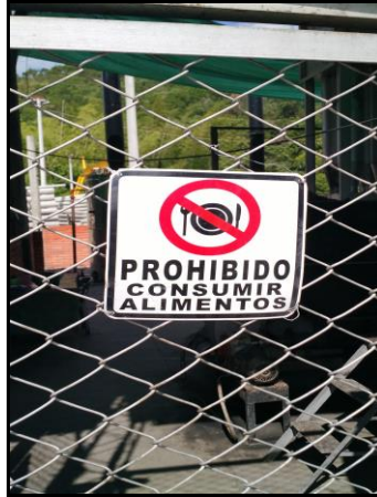
Ilustración 17 Señalizaciones en zona de calderas.
