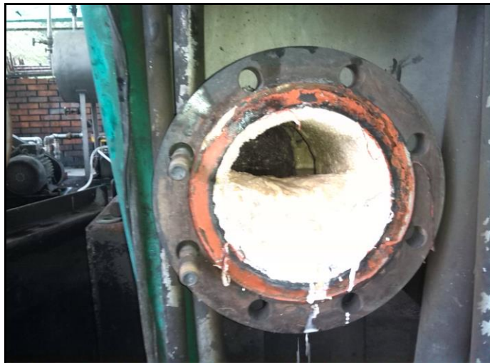
Ilustración 13 Tubo madre de sistema de purga.
