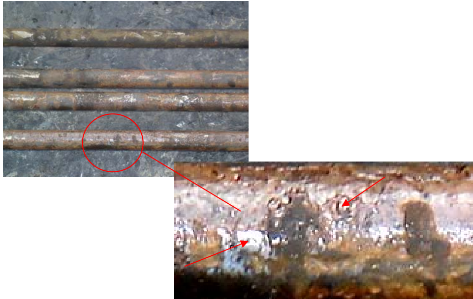
Figura 4-51: Corrosión en varilla. Ampliada.
