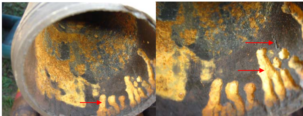
Figura 4-9: Muestra de Corrosión severa en pin
