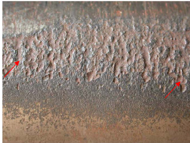
Figura 4-55. Área externa del shear coupling con corrosión pitting.
