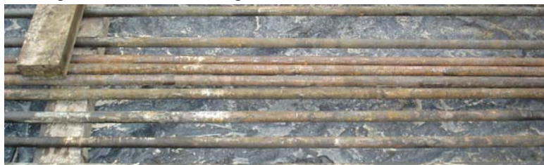
Figura 4-50: Corrosión general en la varilla convencional.
