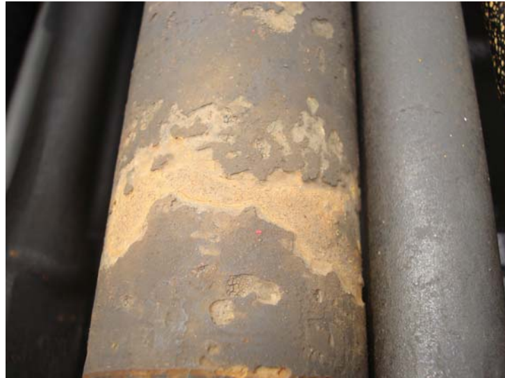
Figura 4-58. Corrosión por CO 2 en tubería de producción.
