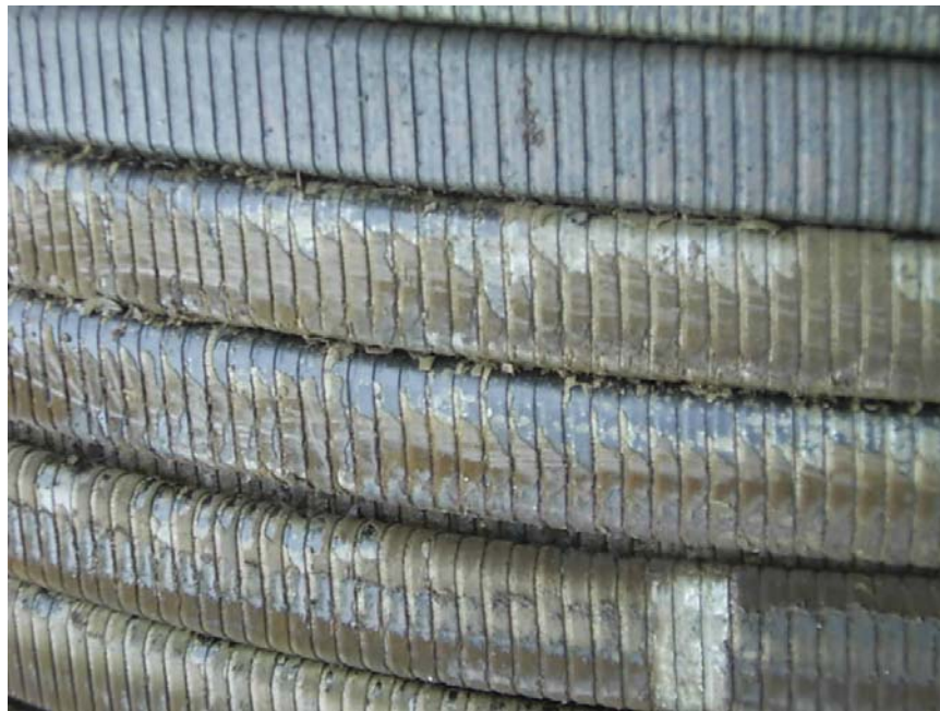
Figura 4-32: Presencia de corrosión en cable plano de ESP.
