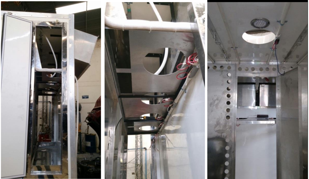
Figura 323. Cuarto del sistema de confort
