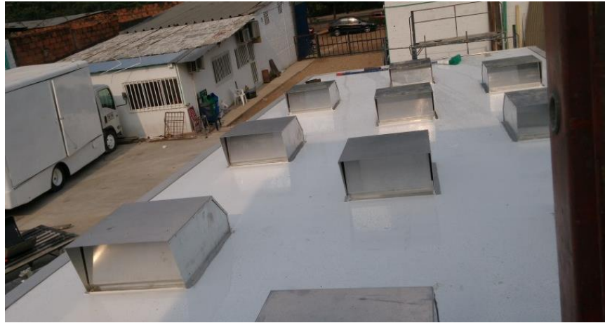
Figura 367. Cajas de protección para los extractores
