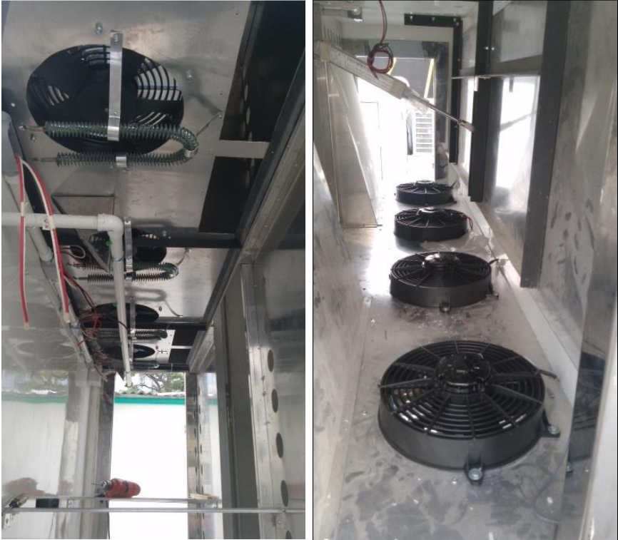
Figura 334. Adecuación de los elementos del sistema de confort
