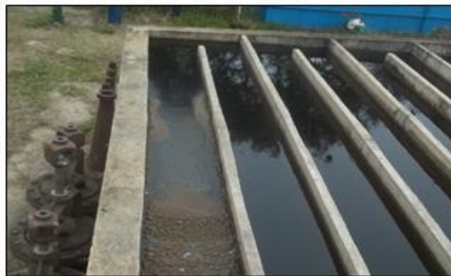
Figura 12. Canaletas de floculación 2
