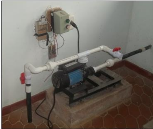
Figura 15. Bomba inyección cloro
