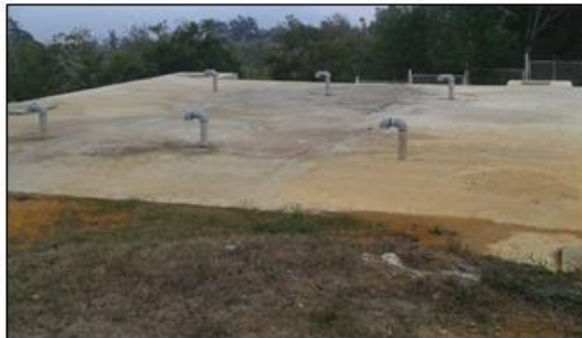
Figura 18. Tanque de almacenamiento 2
