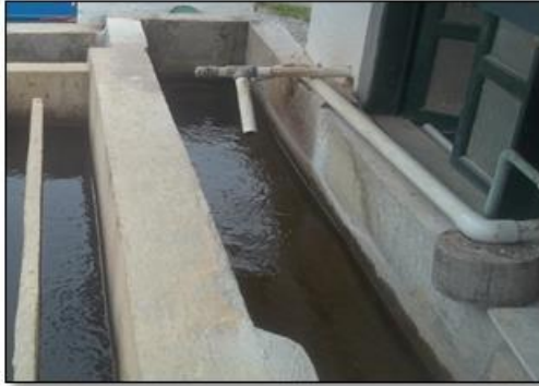
Figura 9. Foto 2 canaleta Parshall
