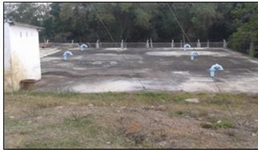
Figura 17. Tanque de almacenamiento 1
