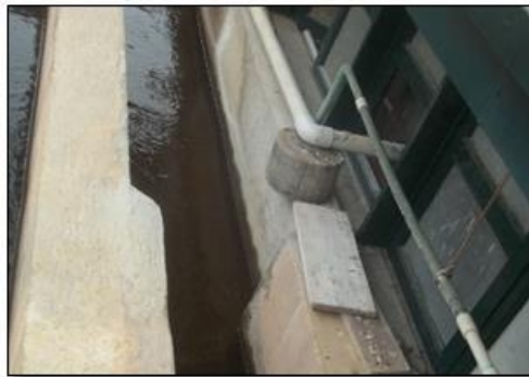
Figura 10. Foto 1 canaleta Parshall
