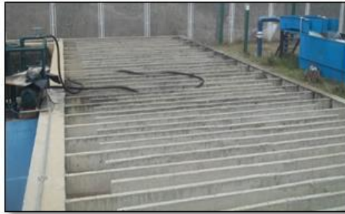
Figura 11. Canaletas de floculación 1
