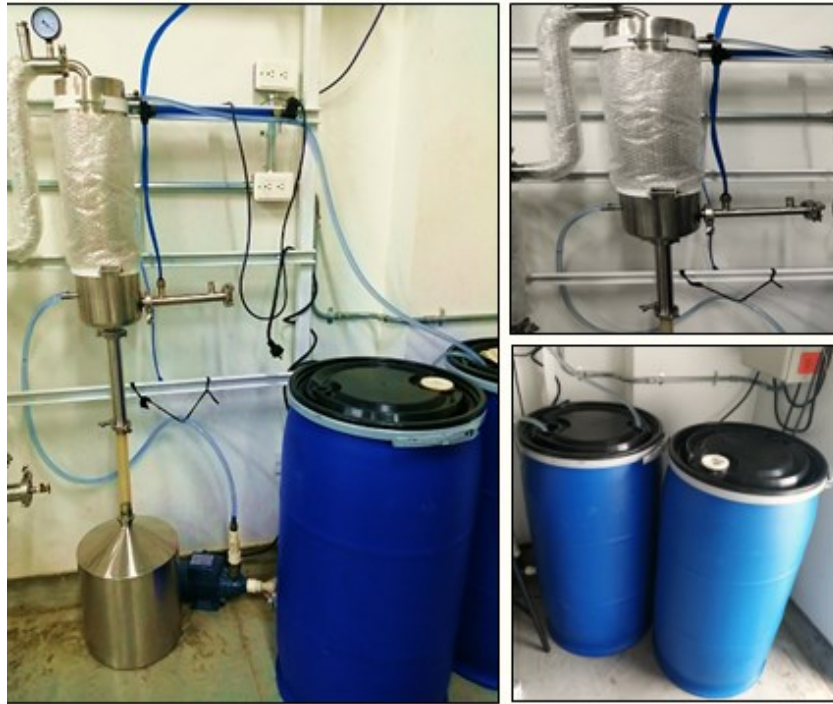
Figura 9. Sistema de enfriamiento con tanques de almacenamiento y recirculación.
