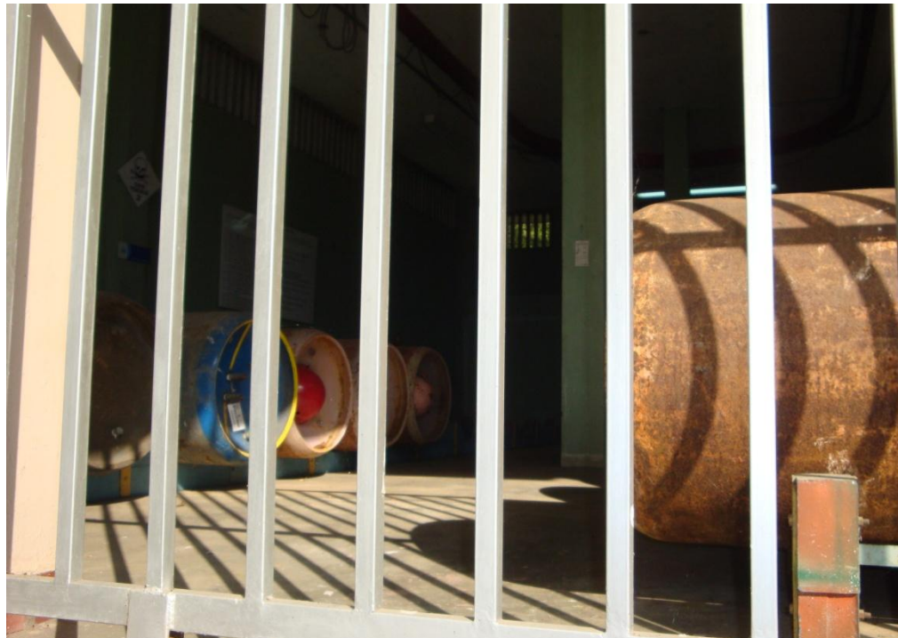
Figura 21. Bodega de cloro.
