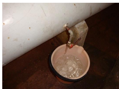
Figura 51. Toma de agua filtrada
