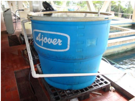
Figura 88. Tanque de agua a tratar
