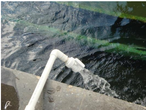
Figura 94. Salida de agua tratada
