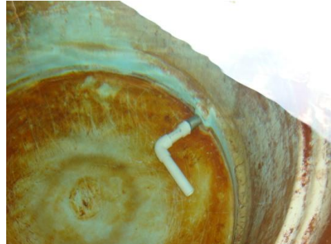
Figura 96. Tanque parte inferior
