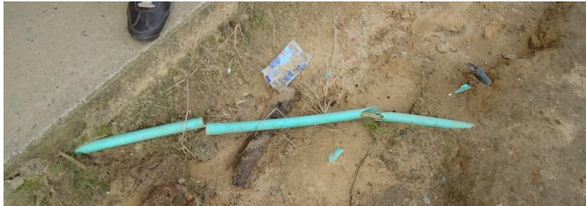
Figura 57 Acometida Deteriorada Fuente: Los Autores.
