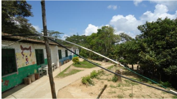
Figura 58 Acometida Aérea Errónea Fuente: Los Autores.
