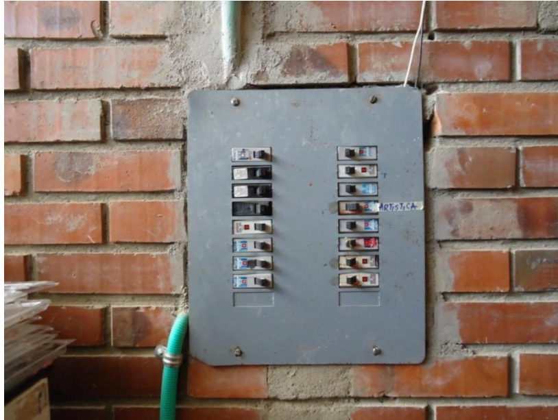
Figura 49 Tablero TA levantamiento Fuente: Los autores.
