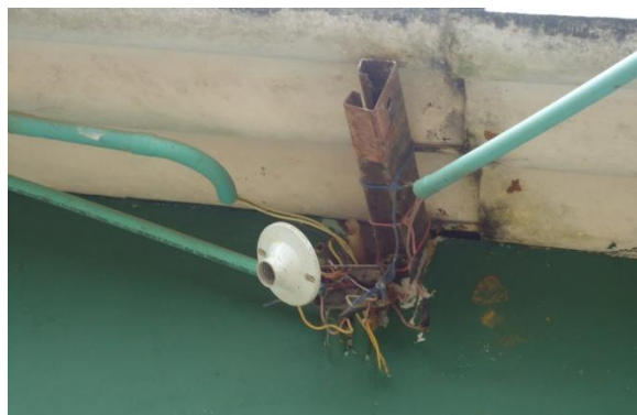
Figura 59 Nodos y Puntos de Unión Deplorables Fuente: Los Autores.
