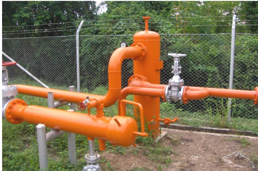
Figura 8. Líneas de Gas.
