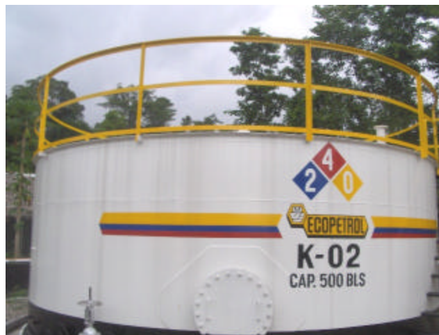
Figura 6. Tanques de Almacenamiento
