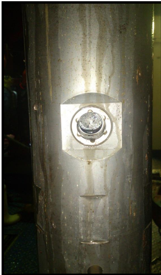
Figura 22. Evidencia de Ruptura de Disco.
