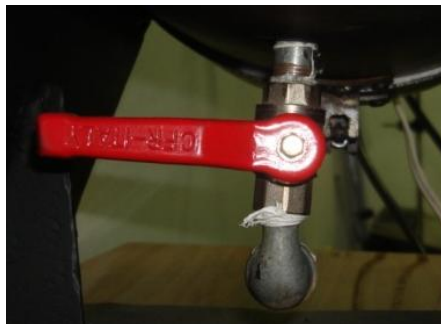
Figura 41. Válvulas globo para el vaciado del tanque
