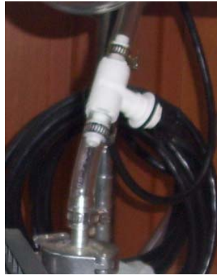
Figura 14. Válvula de control del vacío
