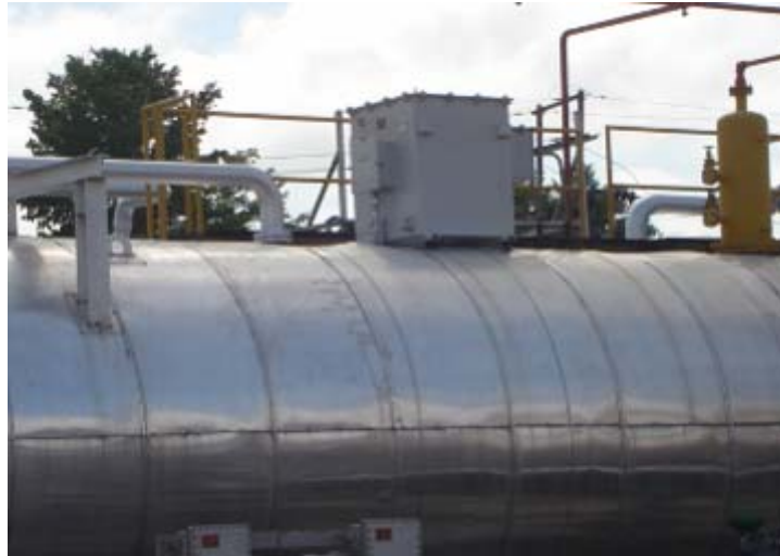
Figura 41. Transformador del sistema de potencia de la Sección de Coalescencia
