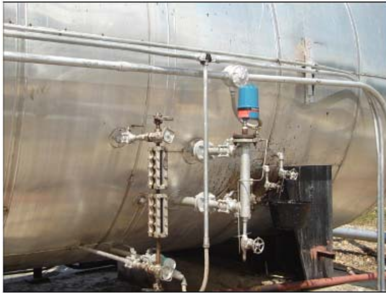
Figura 49. Fotografía del control de nivel de la Sección de Coalescencia.
