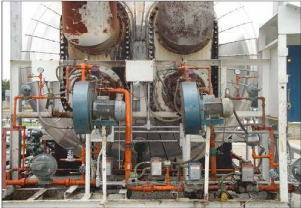
Figura 13. Sección de Desgasificación
