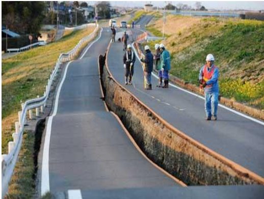
Figura 1: Carretera en Saitama afectada por la licuefacción de suelos
