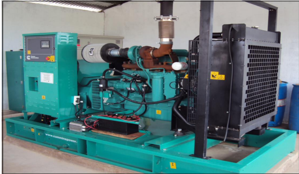
Figura 21 Planta de emergencia.
