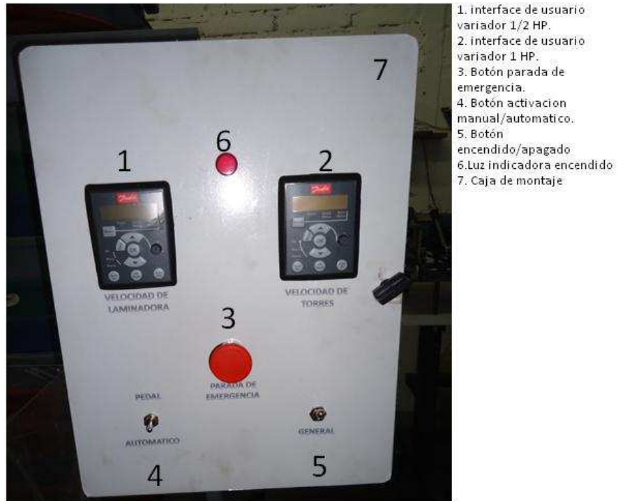
Figura 156. Vista frontal del tablero de control. Componentes
