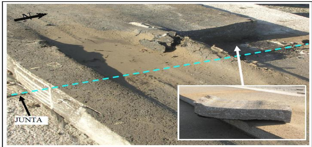
Figura 4.38. Fenómeno ocurrido sobre la junta N° 2
