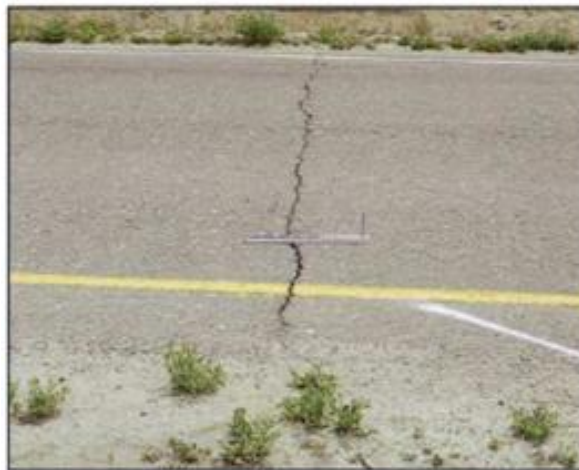
Figura 1.6. Fisura transversal al eje de la carretera.
