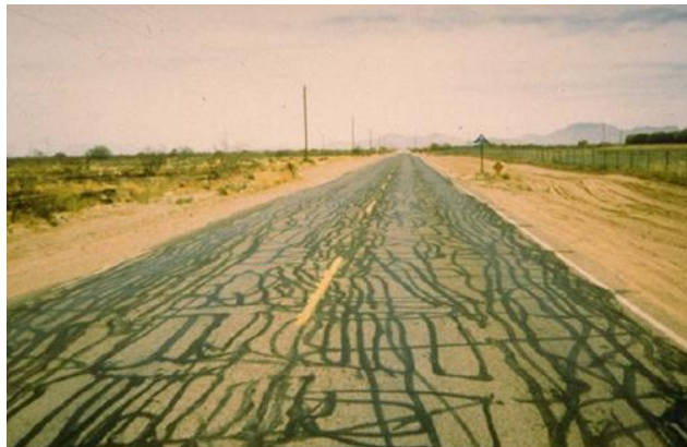
Figura 3.4. Exceso de sellado de fisuras
