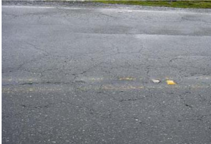
Figura 1.5. Evolución de daños a fisuras en bloque
