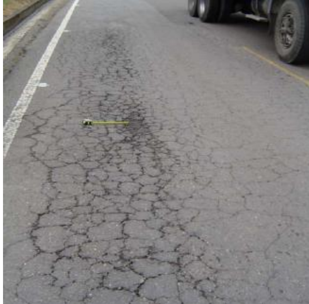
Figura 1.9. Deterioro del pavimento formando una malla subdividida
