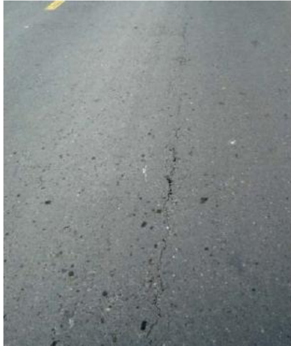
Figura 1.2. Representación de una fisura longitudinal
