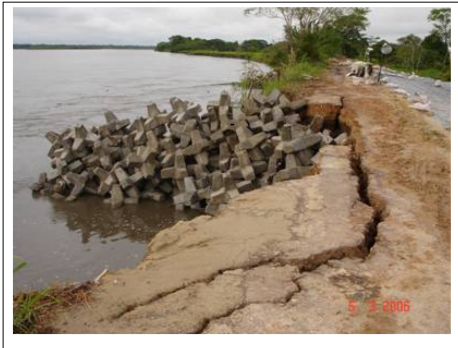
Figura 48. Fracturamiento del dique de Yondó en Puntas Carmelitas.
