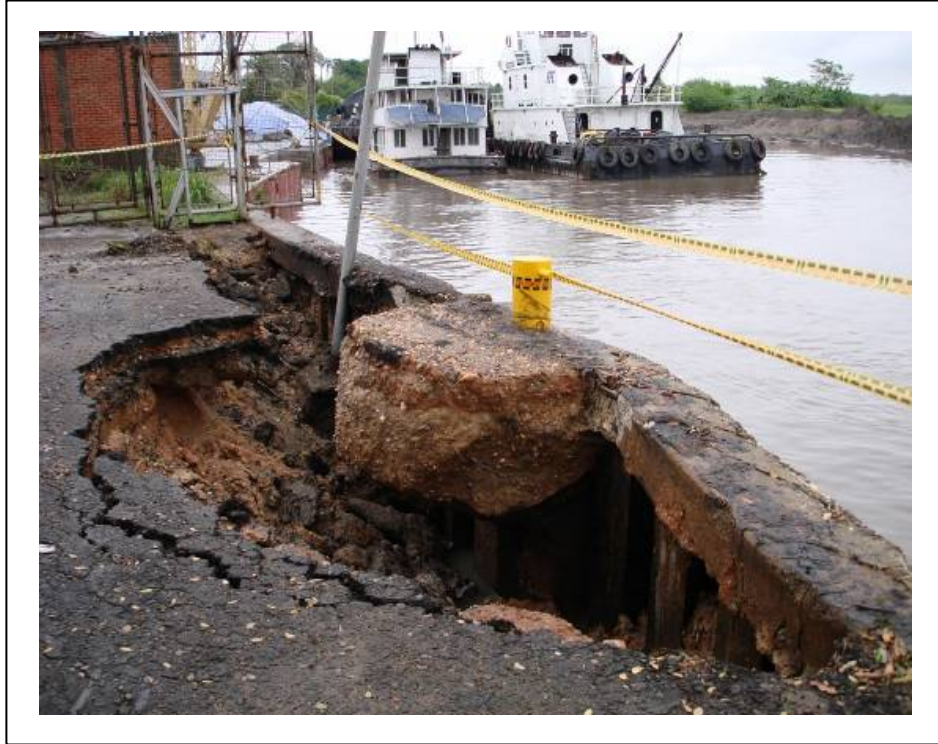
Figura 51. Socavación del tablestacado Muelle 1 Refinería (Agosto 2006)
