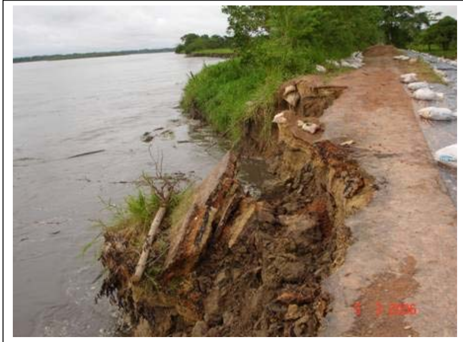
Figura 50. Erosión de la orilla en Punta Carmelitas.
