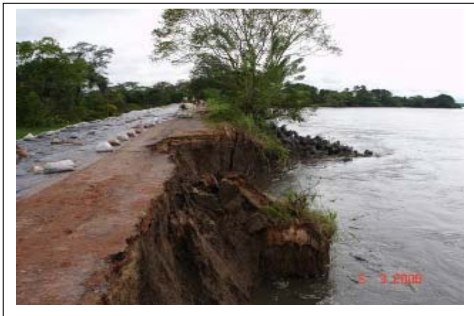
Figura 49. Socavación y erosión de la base del talud que conforma la orilla.
