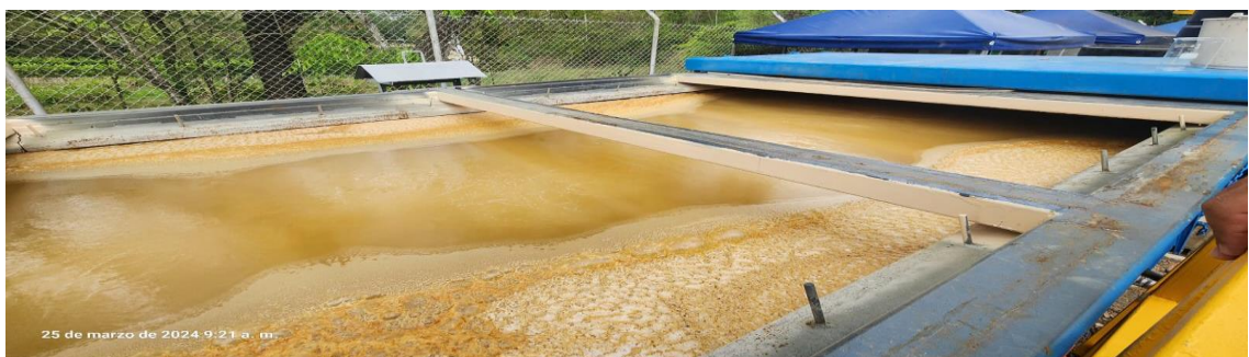
Figura 9 Espuma con hierro y suciedad en tanque de pretratamiento.
