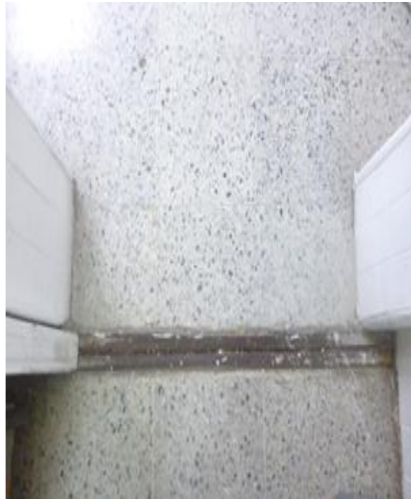
Imagen 10. Rieles de la puerta de acceso al archivo en mal estado. 1 Agosto de 2013.
