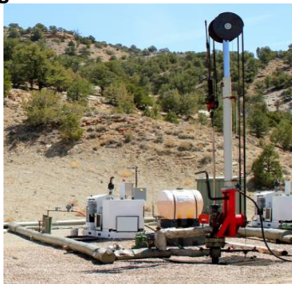
Figura 7. Unidad de bombeo Corlift
