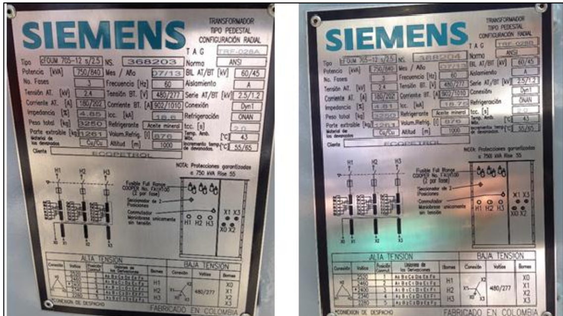
Figura 36. Placas de transformadores gemelos
