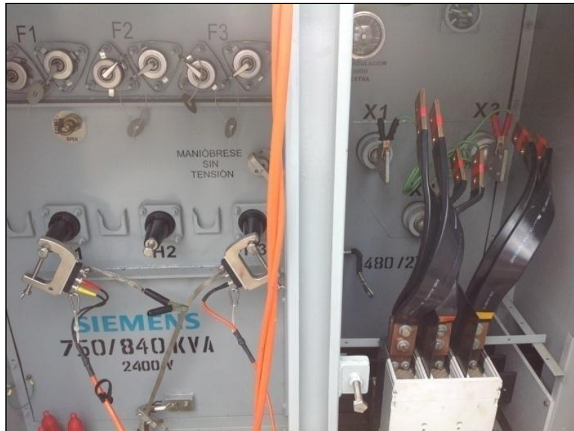
Figura 24. Conexión H1-H3 prueba de corto circuito
