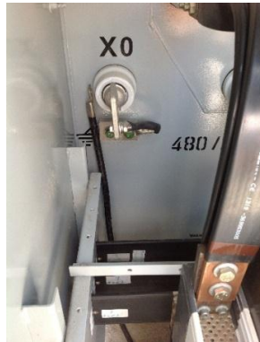
Figura 37. Neutro sin conexión a malla de puesta a tierra
