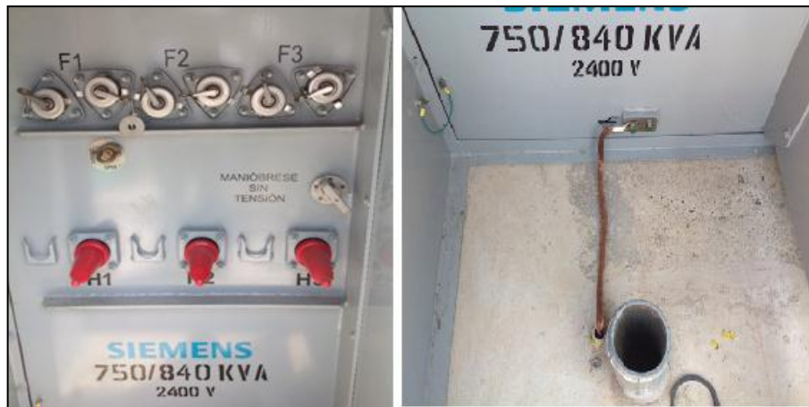
Figura 16. Transformador aislado de fuente de alta tensión debidamente conectado a la malla de puesta a tierra
