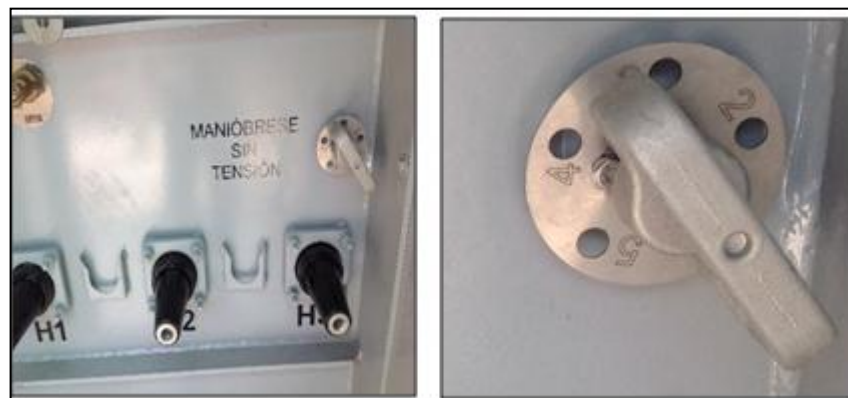
Figura 38. Posición del cambiador de tomas para los transformadores
