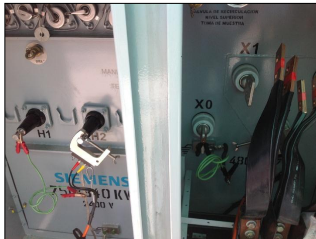
Figura 29. Conexión H2-X2 prueba de inductancia entre bobinados
