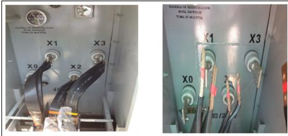
Figura 17. Desconexión de bornes de baja tensión
