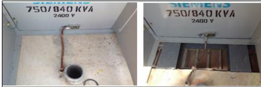
Figura 35. Conexión a malla de puesta a tierra de los transformadores
