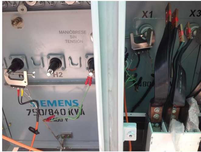
Figura 28. Conexión H1-X1 prueba inductacia entre bobinados
