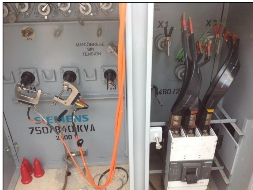
Figura 25. Conexión H2-H1 prueba de corto circuito
