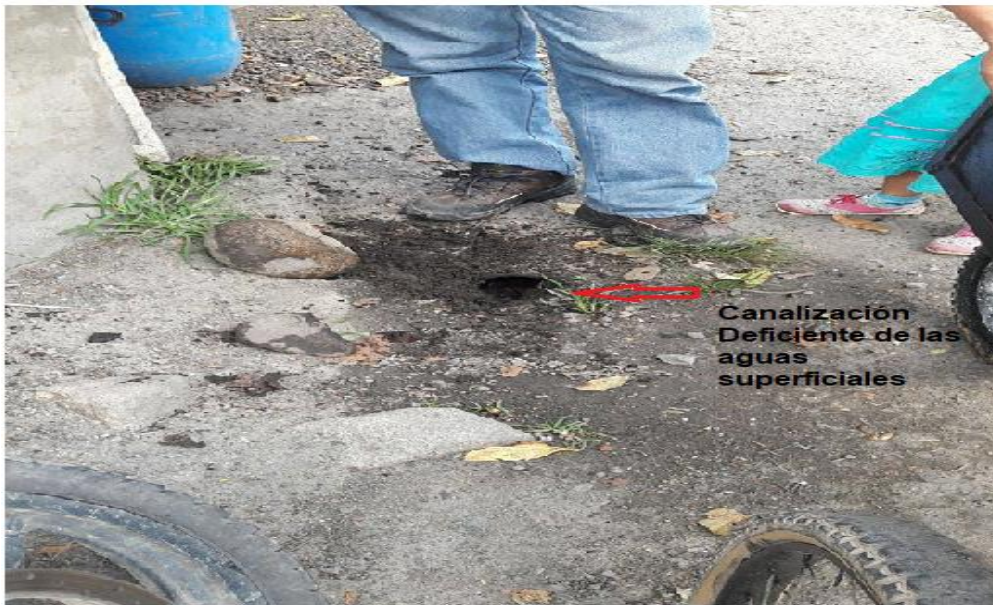
Fotografía 3. Canalización deficiente de las aguas superficiales.
