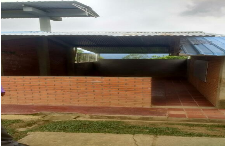
Fotografía 12. Aulas inconclusas en la sede principal de la Institución Educativa del corregimiento de Llano de palmas.
