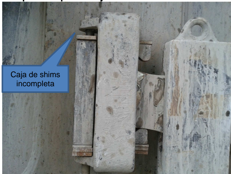
Ilustración 51. Espacio superior caja de shims
