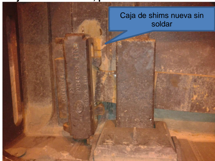
Ilustración 53. Caja de shims caída, por falta de soldadura
