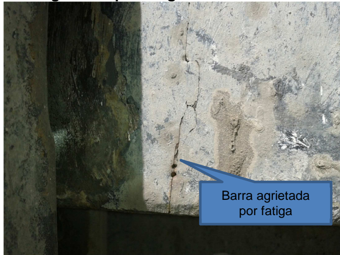
Ilustración 46. Barra agrietada por fatiga
