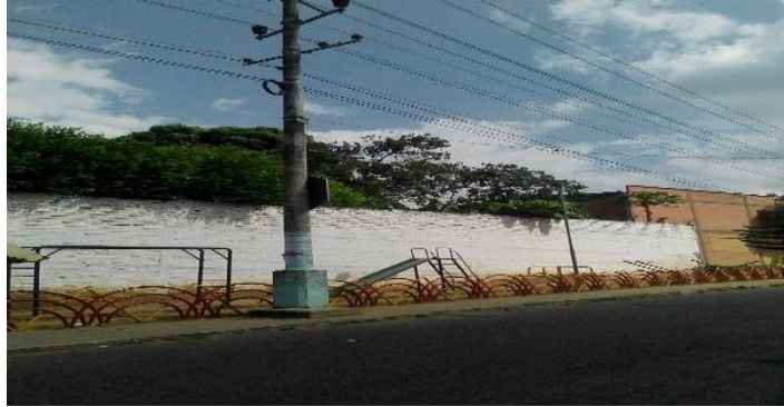
Figura 11. Poste ubicado en el tramo de la carrera 25 entre calles 7 y 9.
