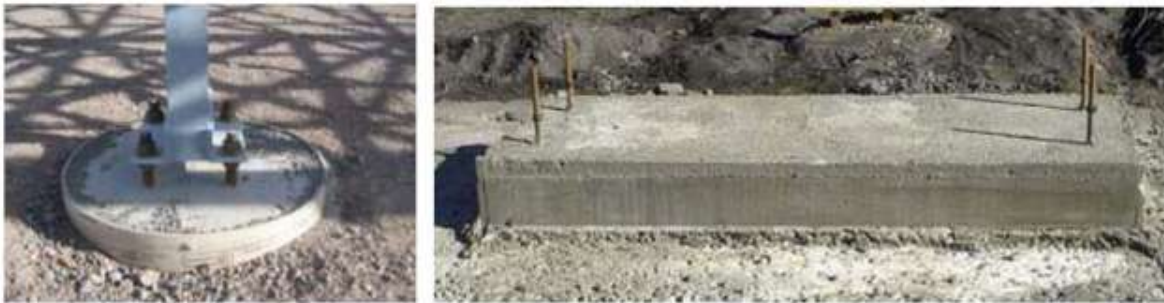
Figura 9. Cimentaciones de colectores cilíndrico-parabólicos.
