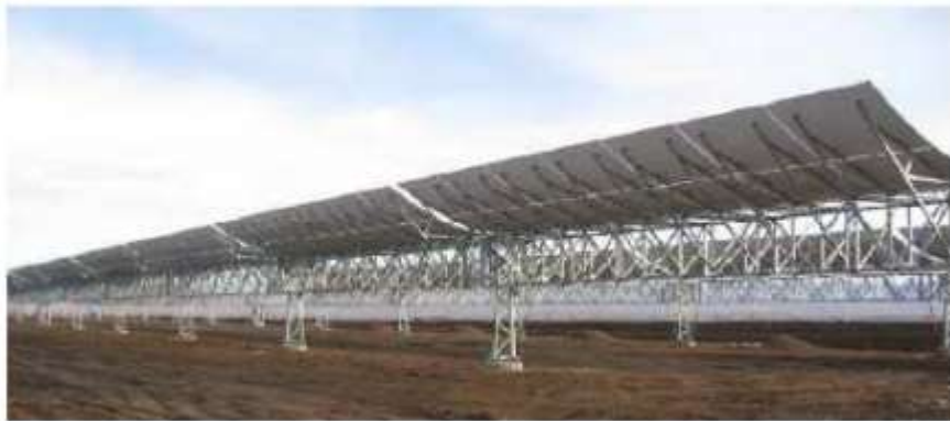
Figura 11. Filas de colectores SKAL-ET
