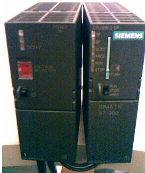
Figura 17. Fuente de alimentación PS307 2A y CPU 315-2DP empleados en el proyecto.
