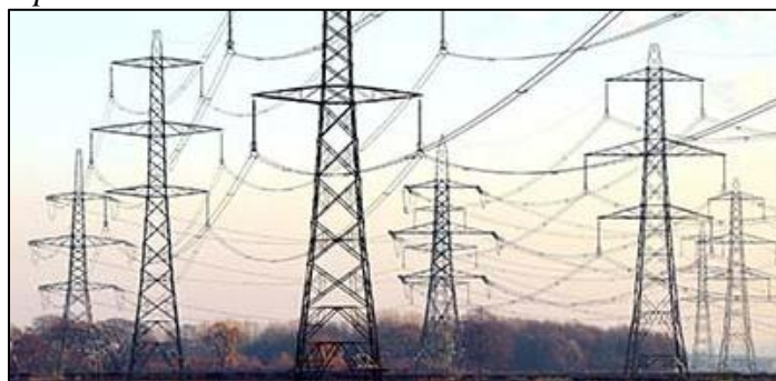
Sistema de distribución de potencia
