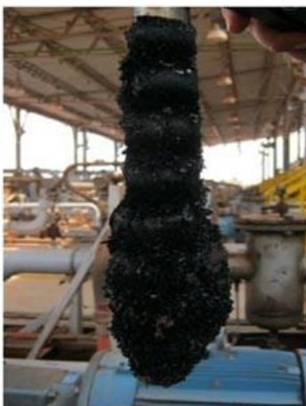
Figura 3. Contaminación por Polvo Negro – Ecopetrol S.A. – ODL Puerto Gaitán, Meta, Colombia.
