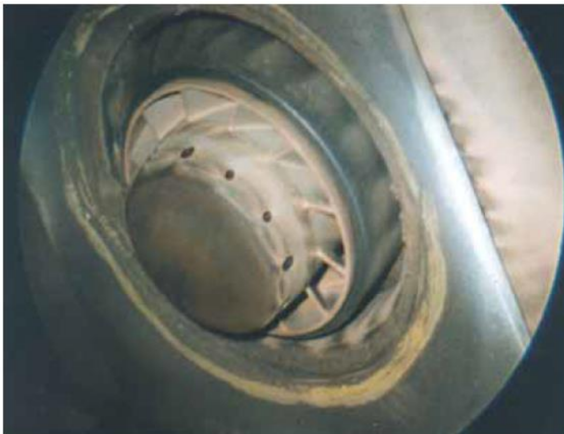
Figura 21. Azufre Elemental Depositado en la Tobera de una Turbina de Gas
