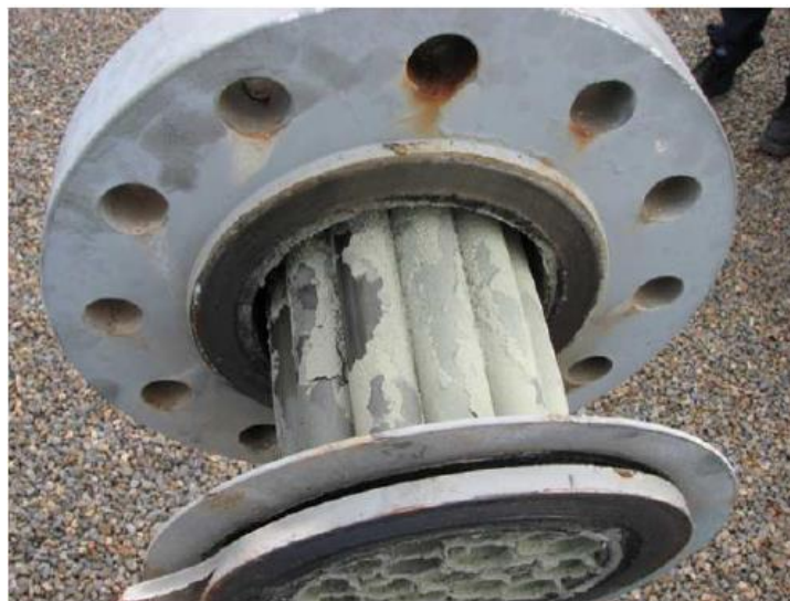
Figura 8. Deposición de Azufre en Tubos Acondicionadores de Flujo
