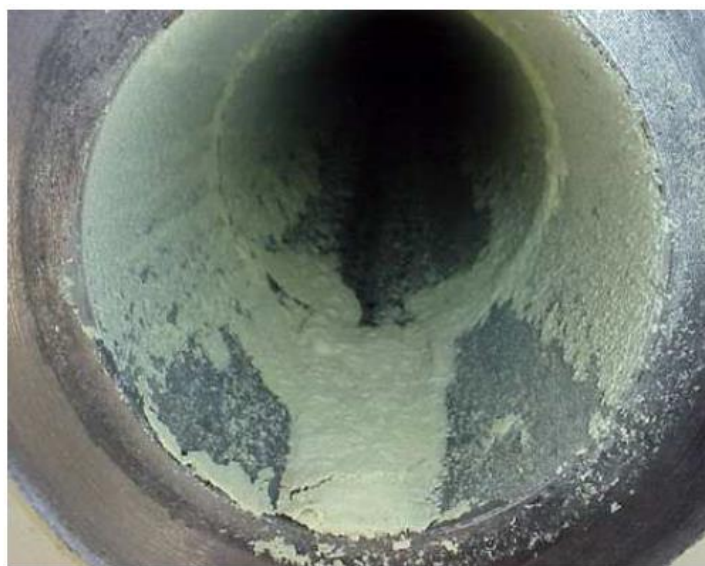
Figura 5. Deposition de Azufre en Tubería Aguas Abajo de un Regulador de Presión
