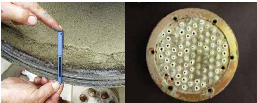
Figura 1. El azufre elemental puede restringir considerablemente o bloquear completamente el flujo a través de los equipos de operación.
